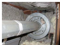
Immagine 1: Il cassonetto passante costituisce una vera e propria voragine energetica, la termografia di fianco testimonia la fortissima dispersione termica che si produce dal cassonetto.
