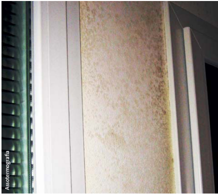
Immagine 4: Formazione di muffa a causa di un ponte termico
