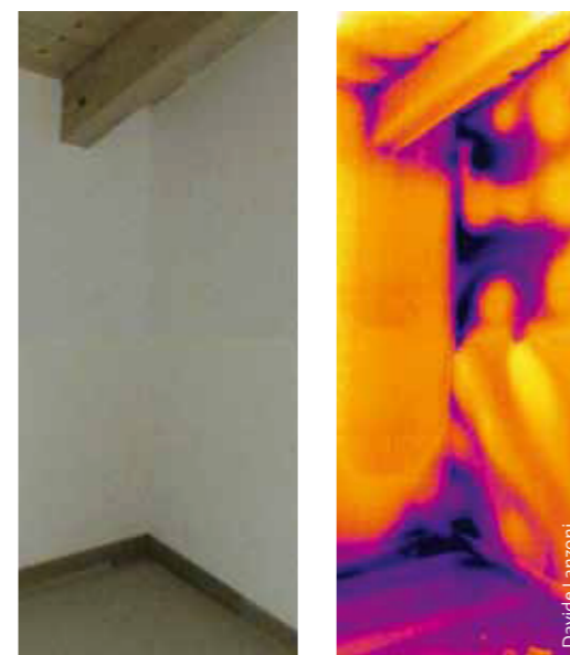
Fig. 6 Thermal bypass di infiltrazioni di aria fredda, dietro controparete interna in cartongesso, provenienti dall'angolo non sigillato tra due muri perimetrali.
